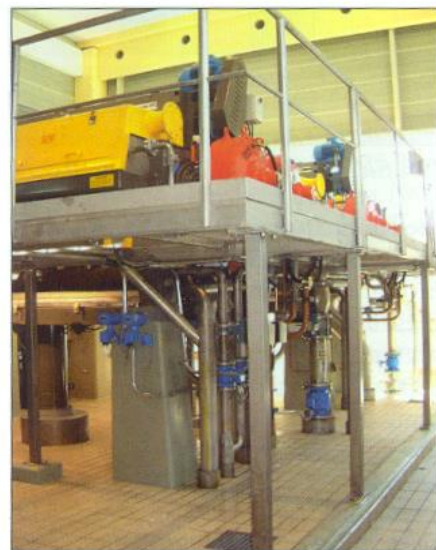
Valmet-Waschpressen im Gebäude der neuen Nachbleiche
